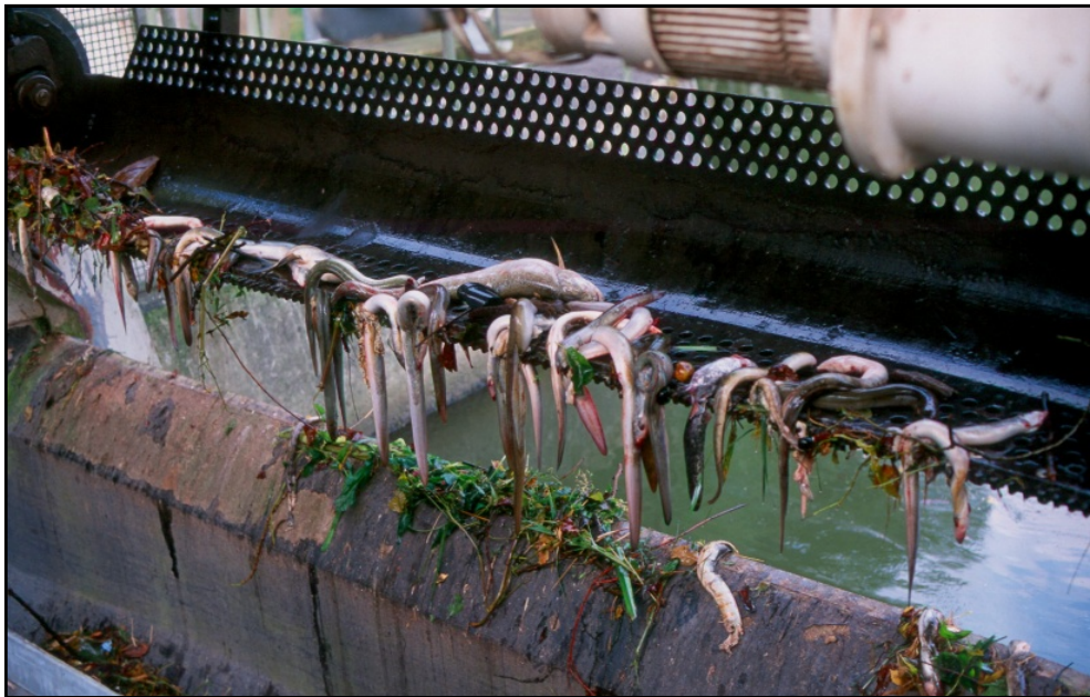
Figure 3.5: Dead eels and fish in a hydropower intake screen cleaning machine (Photo: Institut für angewandte Ökologie)
